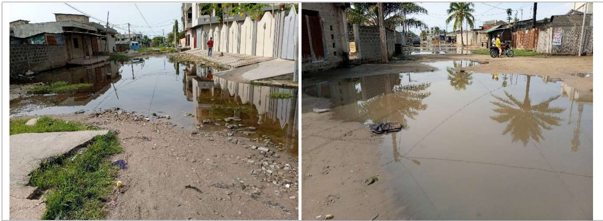
Planche 6 : Etat de dégradation de la voie Akpokpota – Agbalilame, Agblangandan
