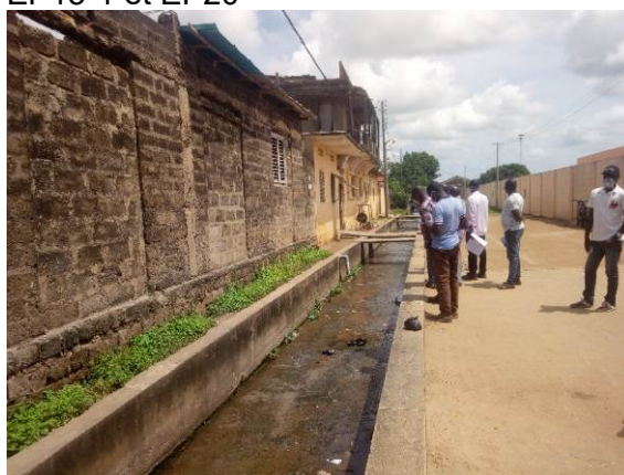
Vue partielle du collecteur EP11 existant
