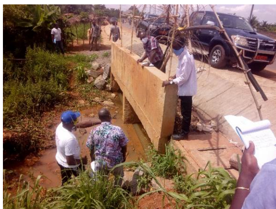
Dallos exutoire des collecteurs EP15, EP15-1 et EP20
