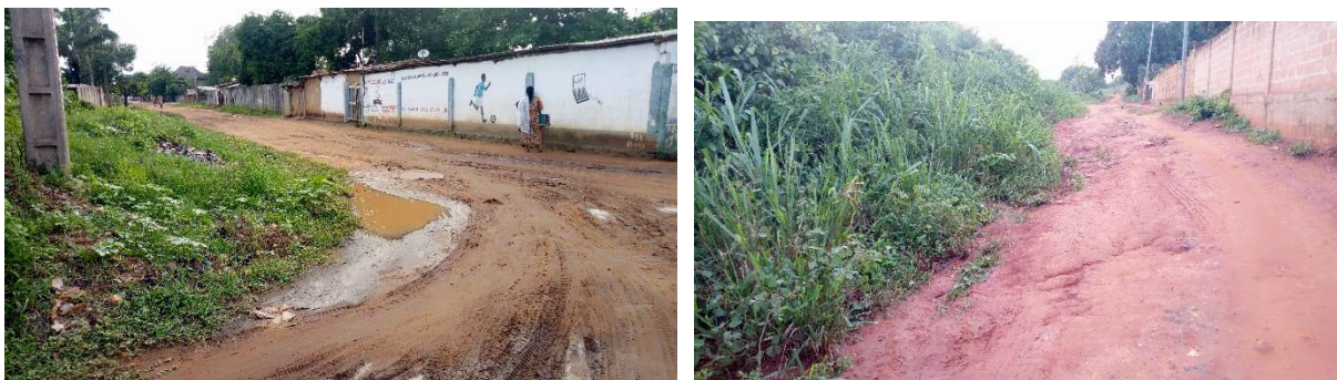
Planche 14 : Etat actuel de la voirie structurante VS-Oui 01 dans le quartier Tovè 2
