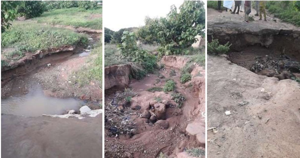
Planche 1 : Rues transformées en rigoles dans le quartier Dokparou
